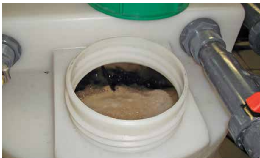
◆ FOT. 2 PROCES OKSYDACYJNEJ REGENERACJI W FAZIE ROZPUSZCZANIA I WYPŁUKIWANIA RESZTEK KOAGULANTU
