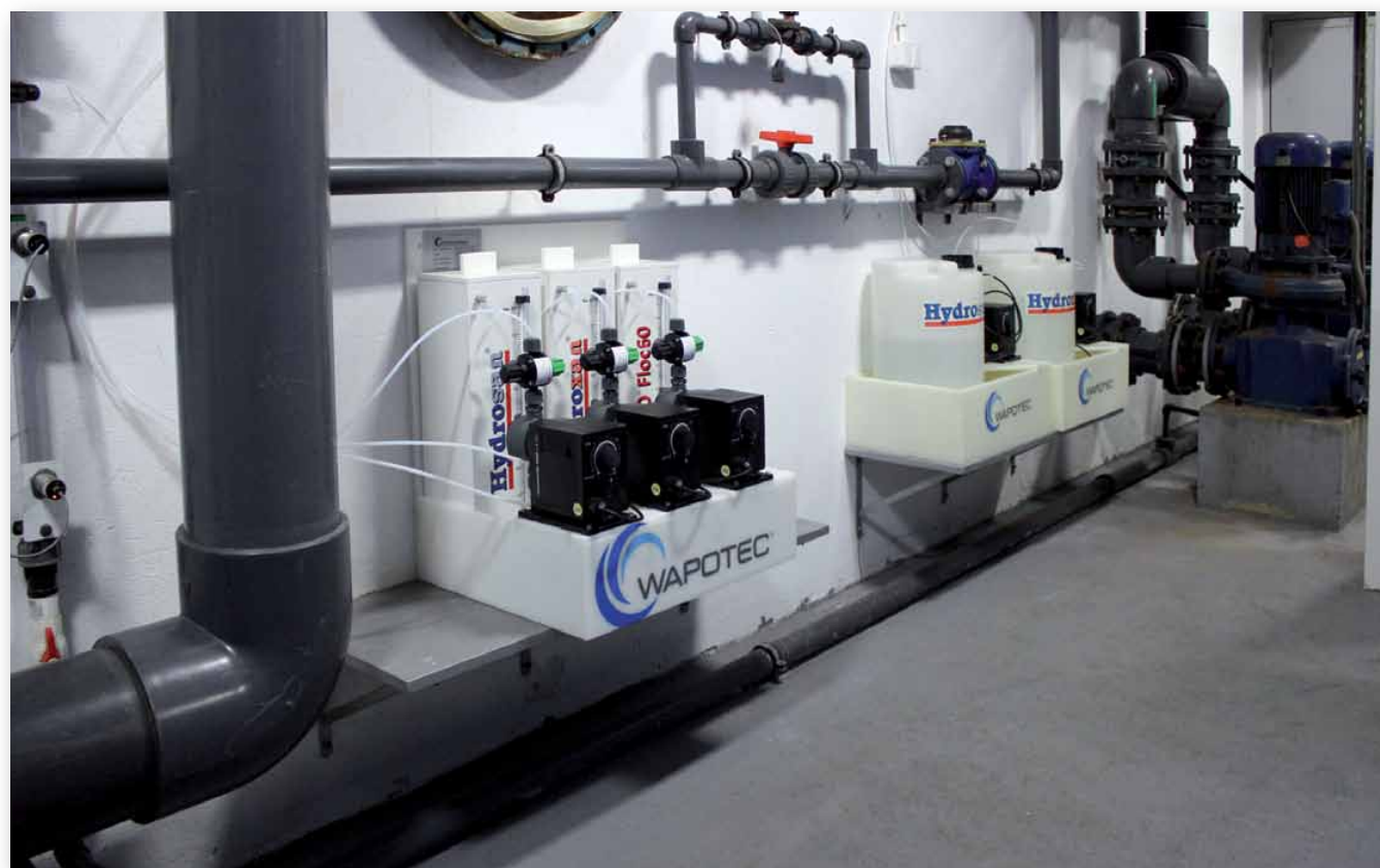
Zestaw urządzeń Doierdepot3 i Dosierdepot SPA w czasie pracy
