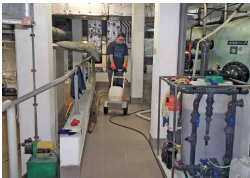
♦ PRACA SPULMOBILA W TRAKCIE REGENERACJI ZŁOŻA W FILTRZE METODĄ DESOPUR®
