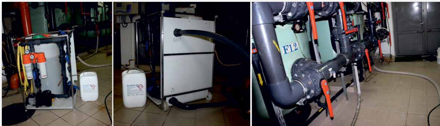
Zainstalowanie i podłączenie Spulmobila w trakcie regeneracji złoża w filtrach
