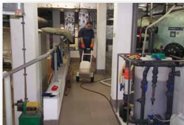
„Spulmobile” w trakcie regeneracji złożeń filtra
