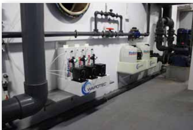
„Dosierdepot 3” i „Dosierdepot SPA”
