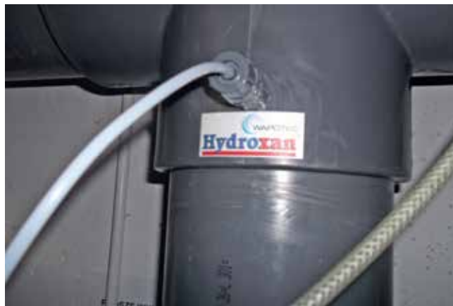
◆ WAPOTEC®SYSTEM – DYSZA DOZUJĄCA HYDROXAN DO OBIEGU UZDATNIANIA WODY WANNY JACUZZI
