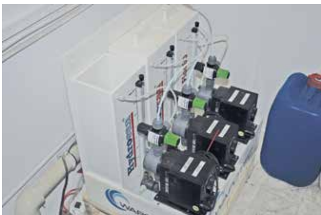
◆ WAPOTEC®SYSTEM – DOSIERDEPOT SPA DAWKUJĄCY HYDROSAN®/HYDROXAN®/WAPOFLOC®
