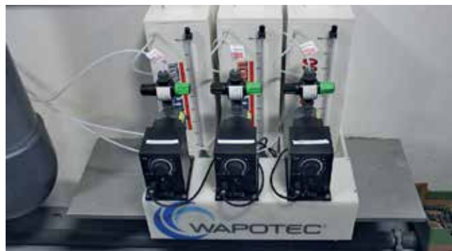
• DOSIERDEPOT SPA DAWKUJĄCY HYDROSAN®/HYDROXAN®/WAPOFLOC®
